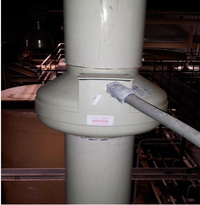
Radon Exhaust Fan on T20
