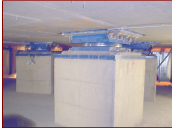
(b) FP bearings below LNG tank basemat
